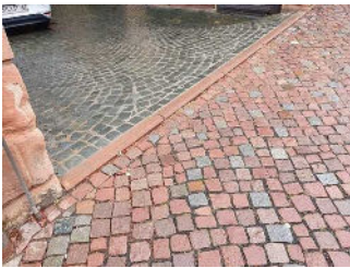
Schwelle zwischen dem Weg und dem Hinterhof im Bereich des Hintereingangs
